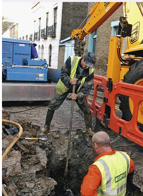
Avant d'arriver chez le consommateur, 1 litre d'eau sur 4 disparaît à cause de fuites dans le réseau.
