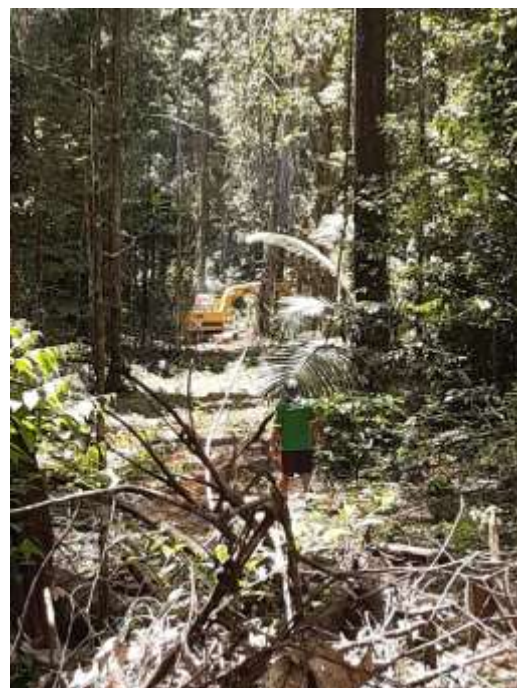
Machine en forêt sur l'emplacement prévu pour la centrale. Crédit : Atopo Wepe
